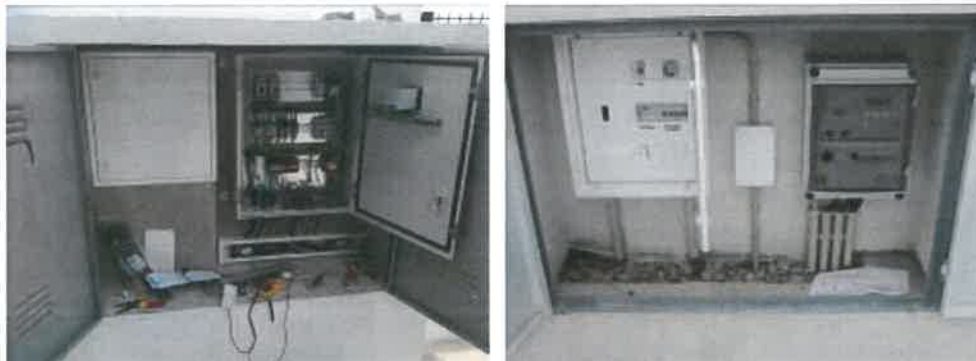
Quadro da Estação Elevatória (QEE)
