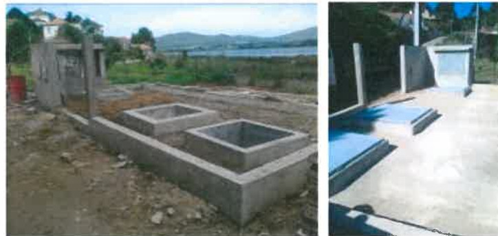
Exemplo de Estação Elevatória
