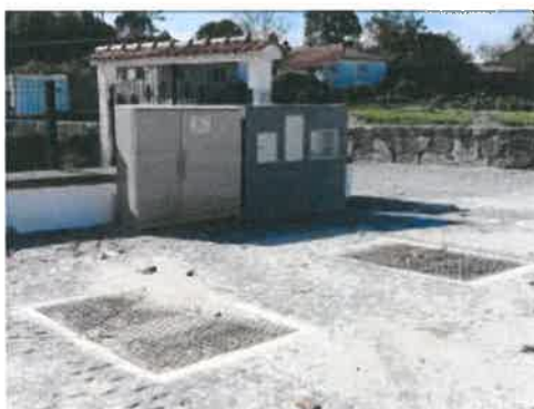
Aspecto final de uma estação elevatória
